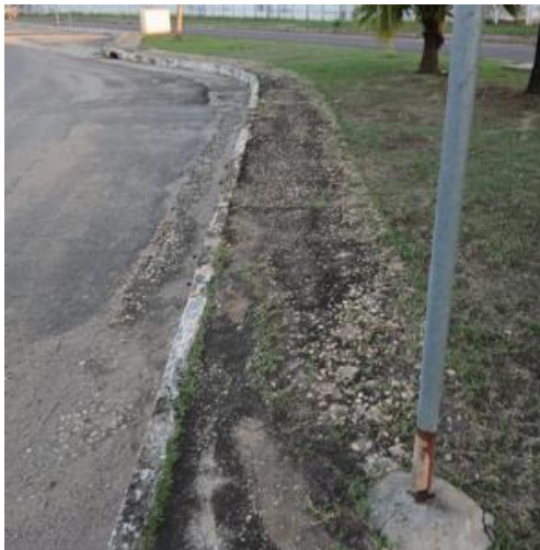
Figura 5 – Calçada com obstáculos, e sinais de degradação.
