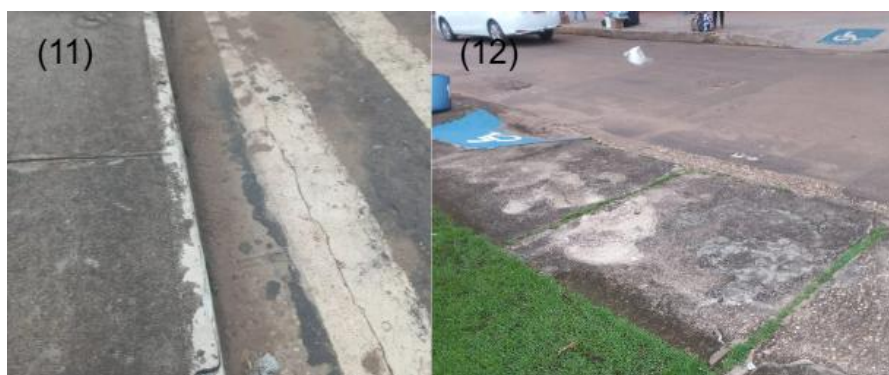
Figura 12 – Ausência de Faixa de pedestres na frente da guia rebaixada.
