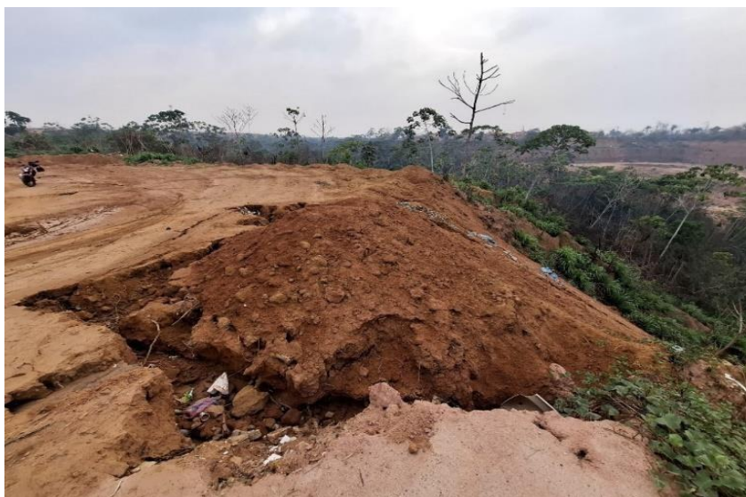
Figura 7 - Deposição de aterro na intensificação da erosão
