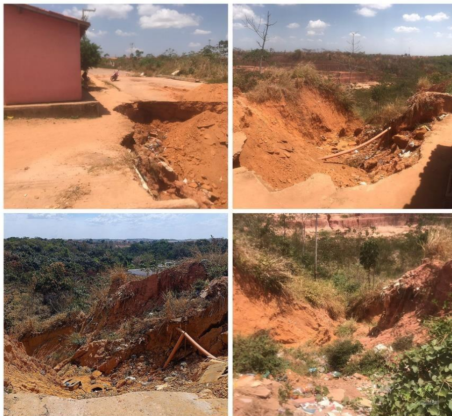
Figura 3 - Imagem de vários ângulos da erosão
