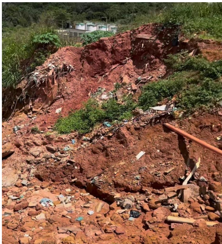
Figura 4 - Erosão agravada pela presença de resíduos
