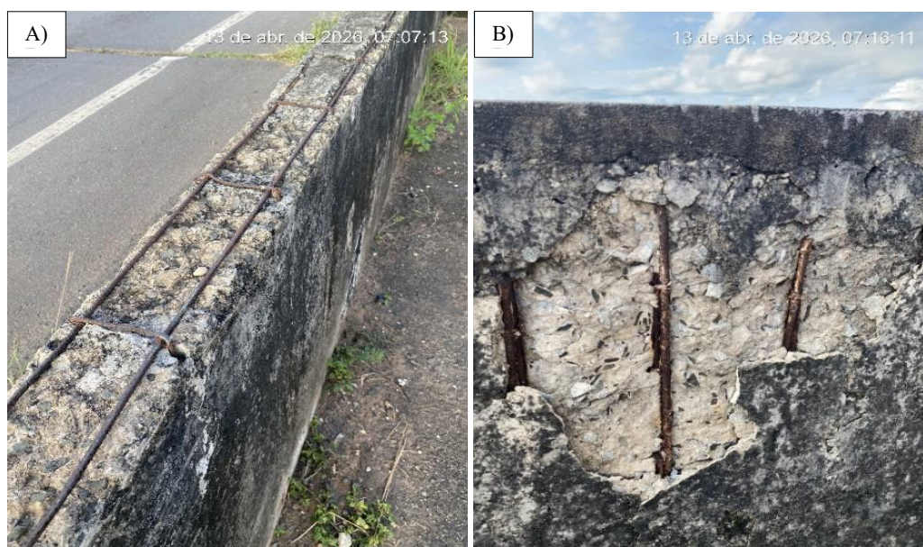
Figura 6 – Exposição de armaduras: a) Perda de cobrimento na parte superior da barreira; b) Desagregação do concreto na lateral da barreira.
