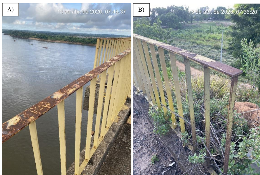
Figura 9 – Oxidação dos guarda-corpos: a) Corrosão e destacamento da pintura; b) Presença de vegetação junto ao guarda-corpo.
