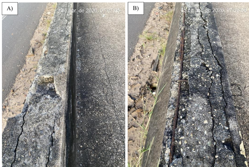
Figuras 14 – Trincas e fissuras a) Na barreira lateral da ponte; b) Fissuras associadas à exposição de armaduras.
