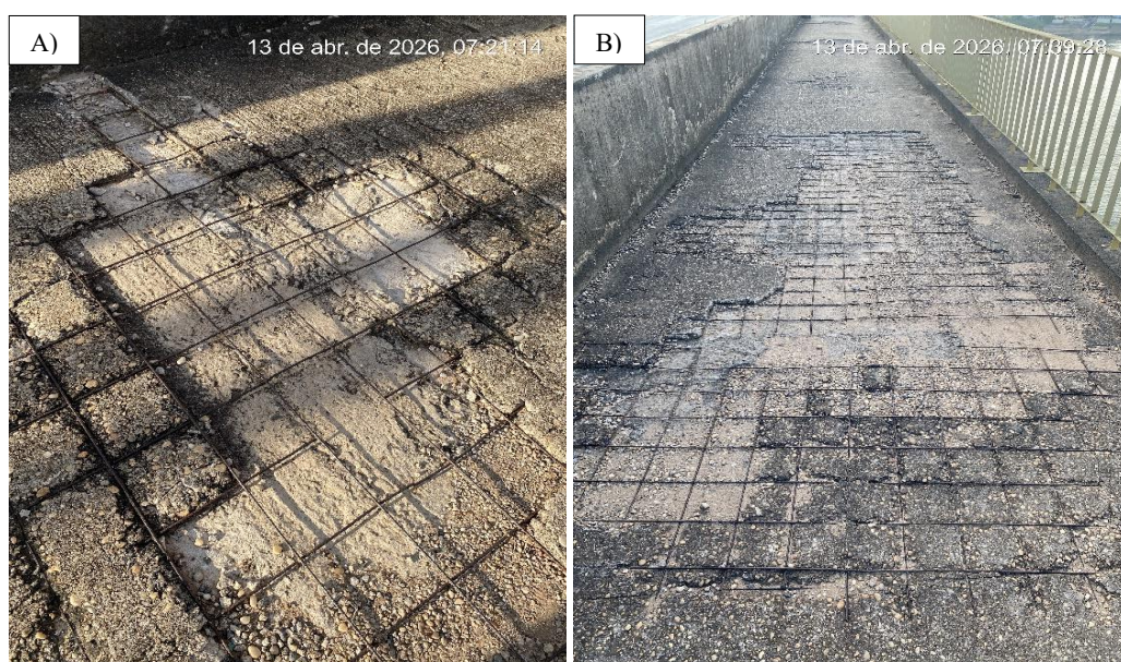
Figura 7 – Exposição de armaduras no passeio: a) Lateral esquerda sentido Maranhão; b) Lateral direita sentido Tocantins.
