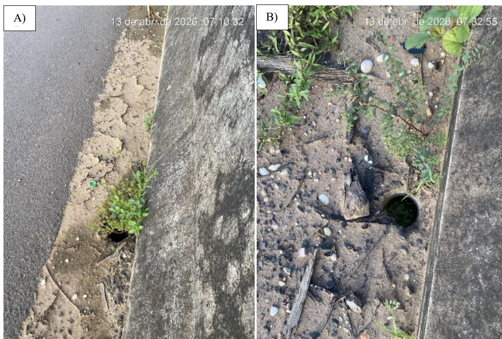
Figura 12 – Falhas no sistema de drenagem: a) Dispositivo parcialmente obstruído por vegetação; b) Acúmulo de sedimentos.
