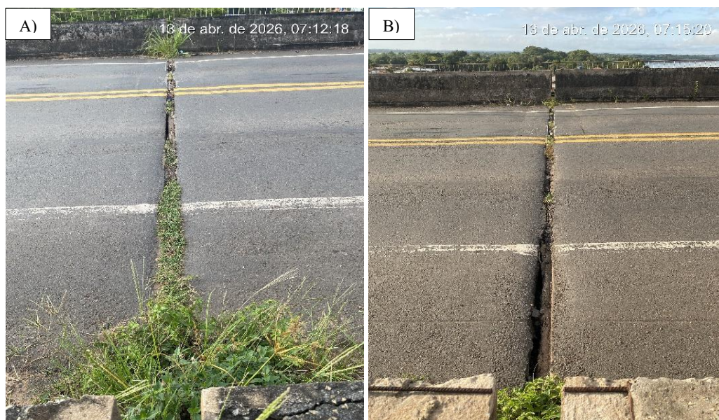
Figura 8 – Falhas nas juntas de dilatação: a) Acúmulo de vegetação e detritos; b) Irregularidades na abertura.
