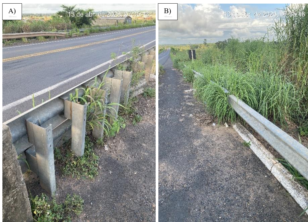
Figuras 13 – Problemas na defesa metálica: a) Presença de vegetação junto à defesa metálica; b) Avanço de vegetação sobre a defesa.
