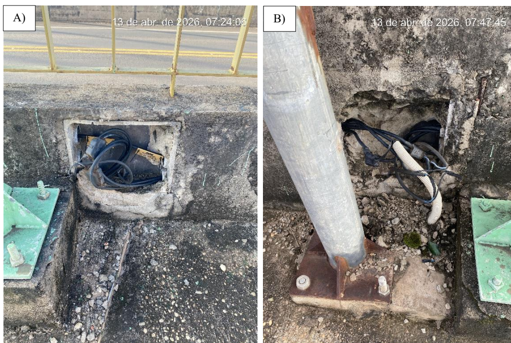
Figura 11 – Instalações elétricas expostas: a) Caixa de passagem com fiação aparente e vedação inadequada; b) Fios expostos junto a base do poste.
