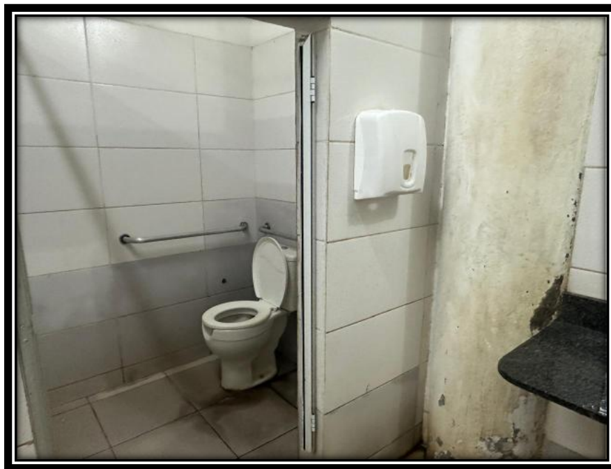
Figura 4 – Condições de conforto: situação dos sanitários
