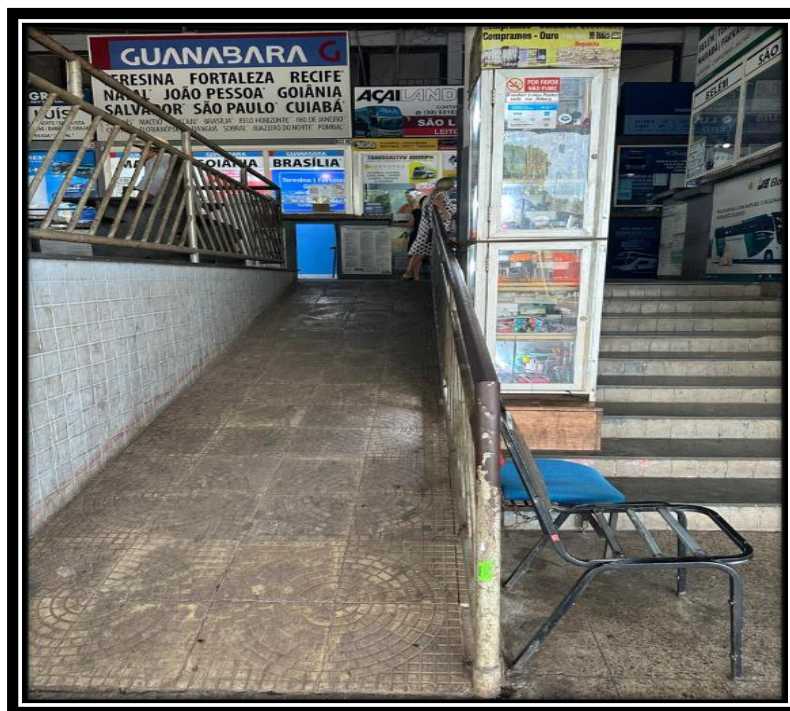
Figura 11 – Inclinação inadequada da Rampa de acesso ao corredor
