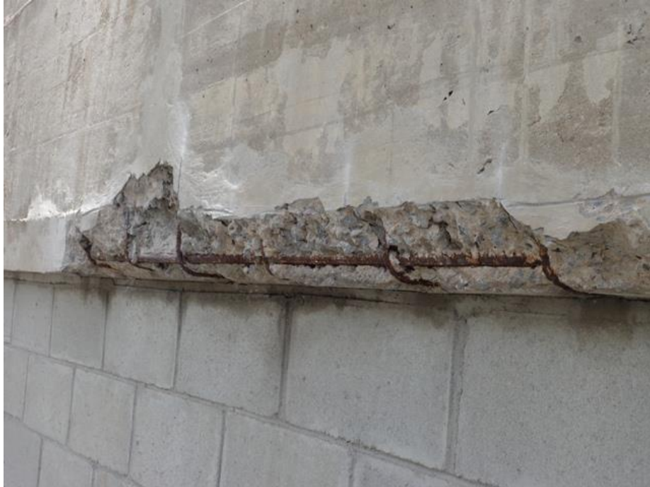
Figura 11 – Despassivação da armadura
