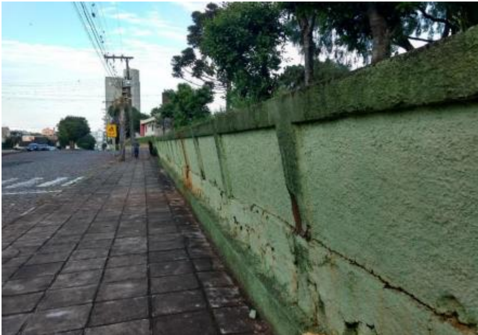
Figura 13 – Vista lateral de manifestação patológica em muro de arrimo
