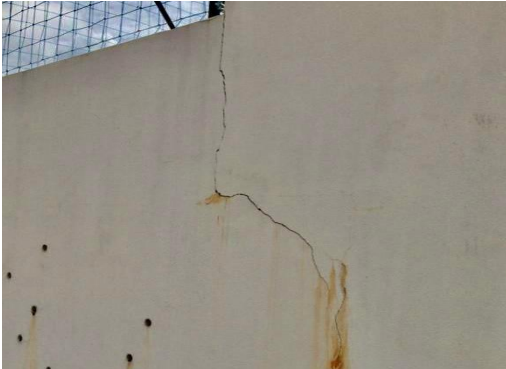
Figura 21 – Vista frontal da manifestação patológica no muro de arrimo
