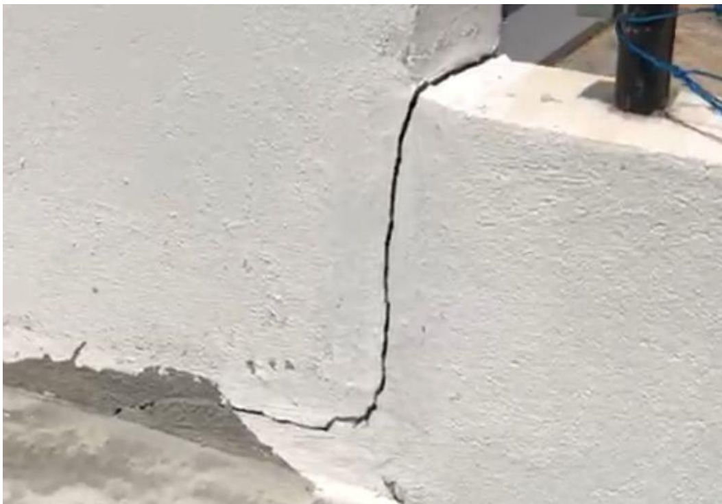
Figura 22 – Vista frontal da manifestação patológica no muro de arrimo
