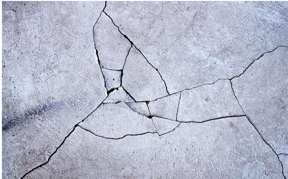
Figura 10 – Fissuração do concreto
