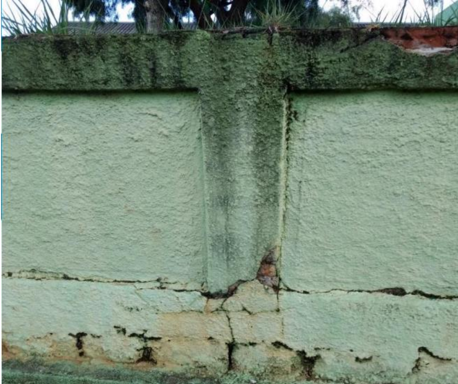
Figura 12 – Manifestação patológica em muro de arrimo
