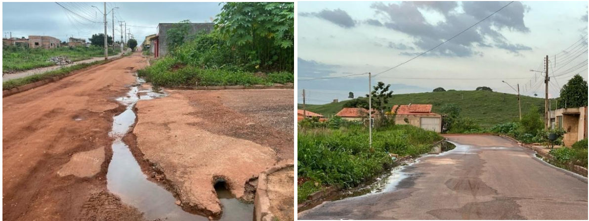
Figura 25 – Acúmulo de água parada nas vias urbanas.
