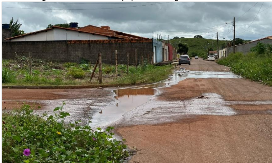
Figura 23 – Trecho de empoçamento de água na Av. Cecília Meireles.
