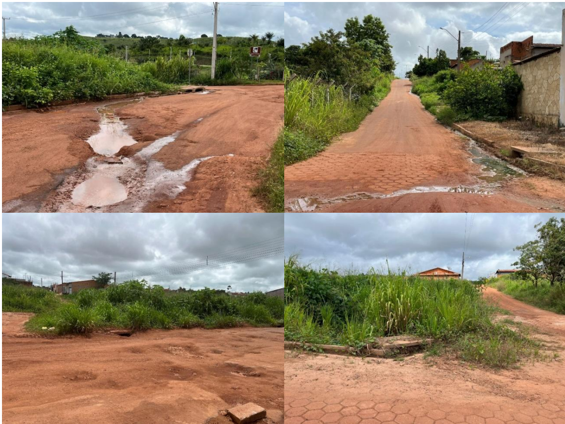
Figura 24 – Condições dos dispositivos de drenagem no bairro Residencial Ouro Verde, Açailândia-MA.
