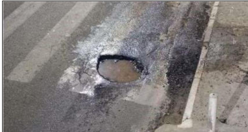
Figura 13 – Painéis ou buracos.
