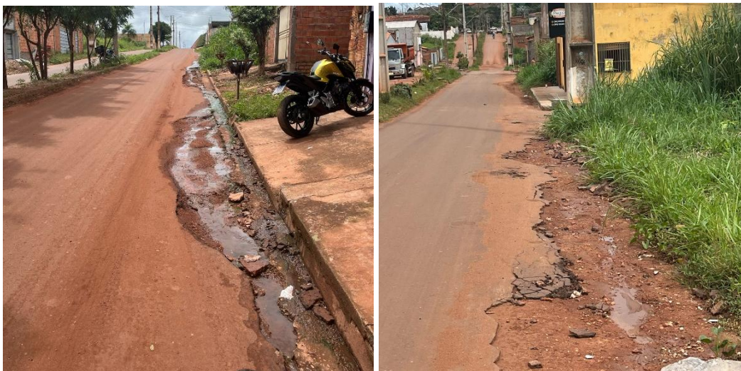
Figura 21 – Desgaste do pavimento e sarjeta, trecho da Av. Adelino de Andrade.
