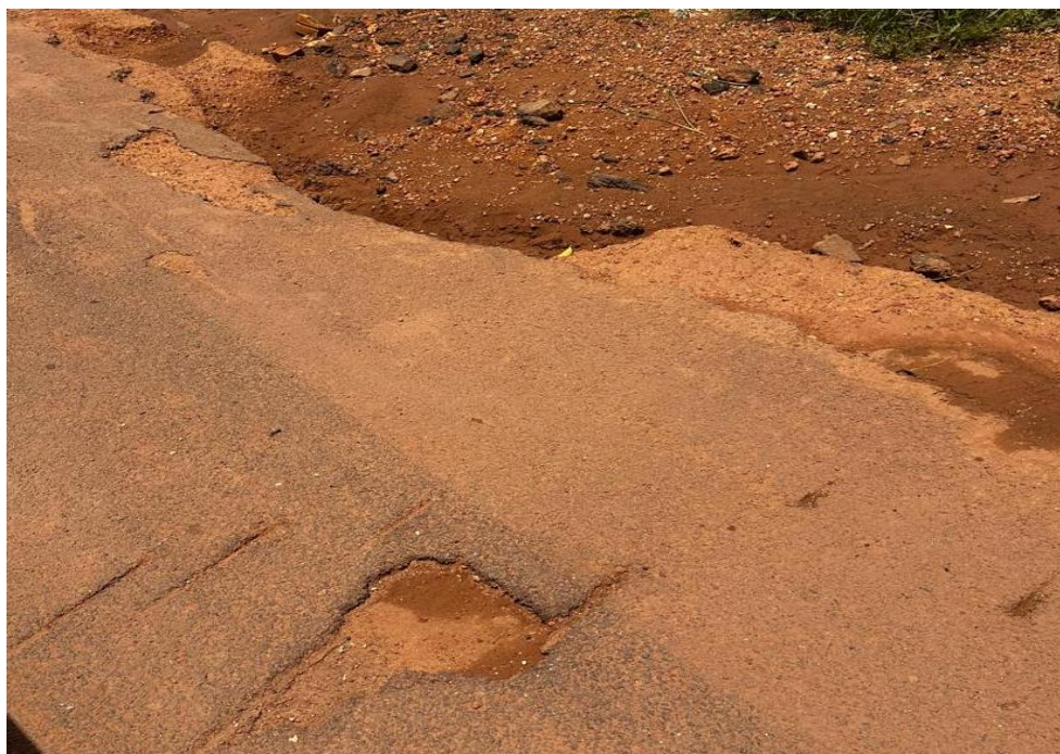
Figura 11 - Surgimento precoce das manifestações patológicas por falta de drenagem apta.
