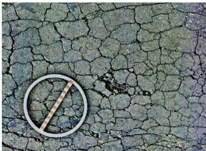
Figura 8 - Trinca interligada tipo couro de jacaré.
