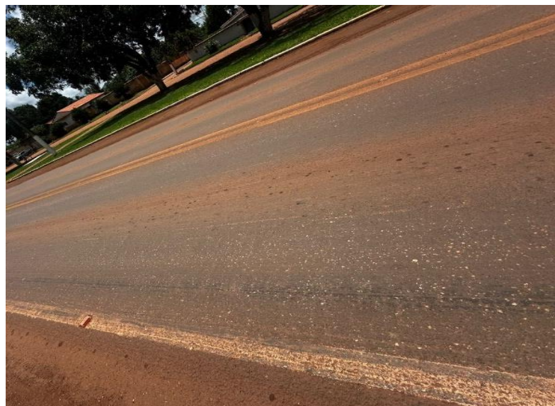
Figura 7 – Desgaste superficial (Exsudação asfáltica).
