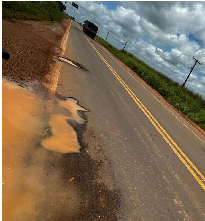
Figura 10 - Deficiência na drenagem, causando degradação do pavimento.
