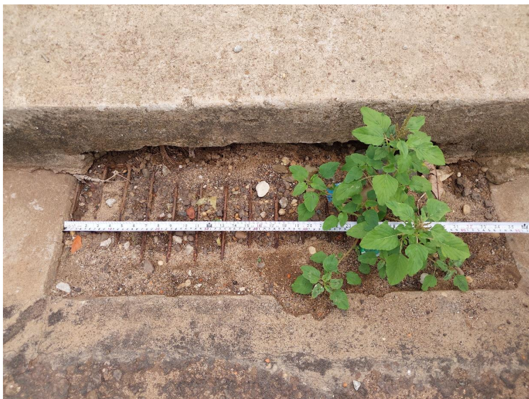
Figura 22 – Boca de lobo completamente assoreada com vegetação
