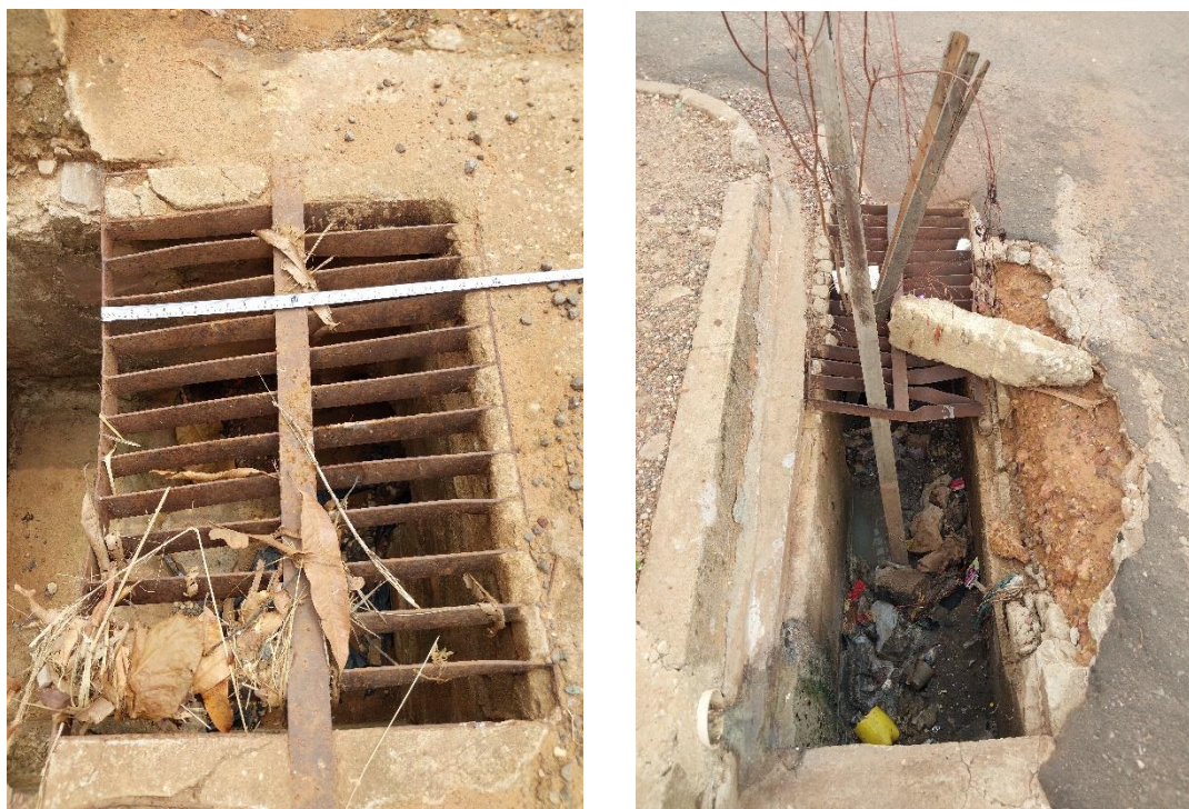
Figura 24: Bocas de lobo com guia total deteriorada
