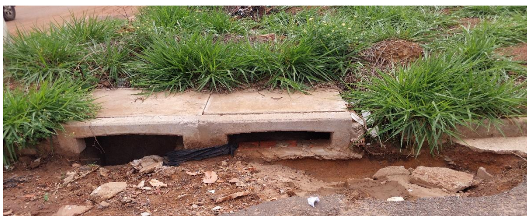
Figura 23 – Bocas de lobo do tipo lateral dupla danificadas
