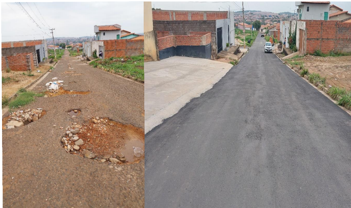
Figura 26 – Rua alimentadora 7 danificada e recuperada
