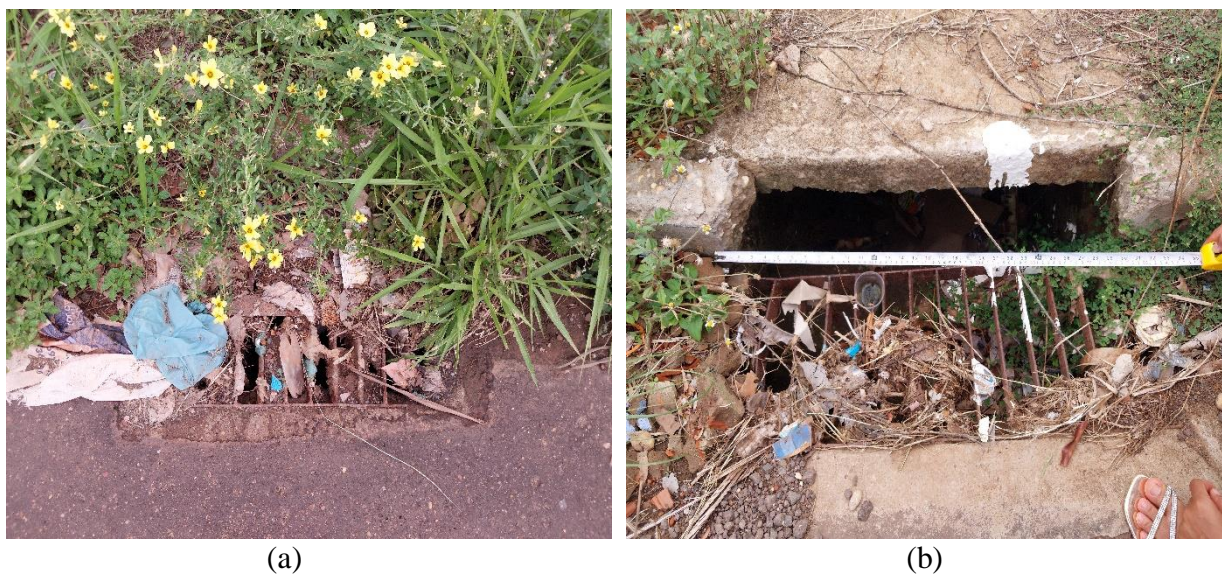
Figura 21 – Bocas de lobo a e b obstruída por resíduos sólidos.
