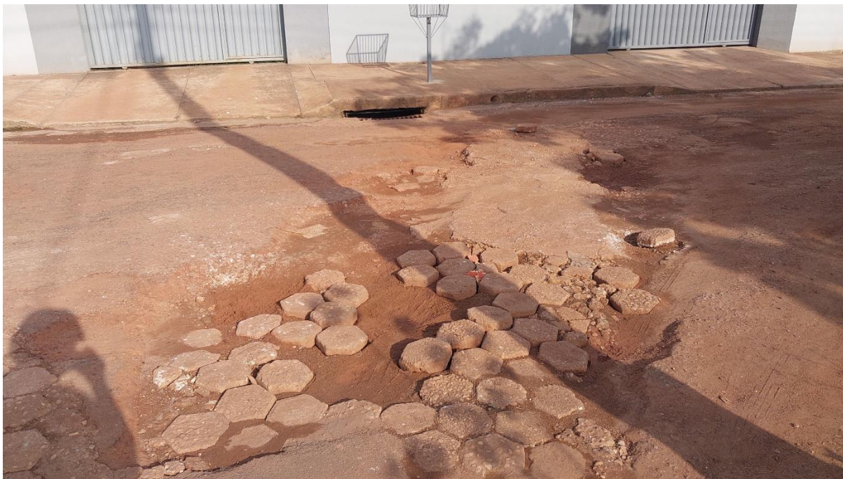
Figura 25 – Degradação do pavimento
