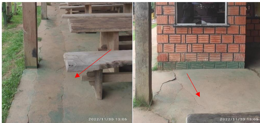
Figura 16: Recalque no piso do salão
