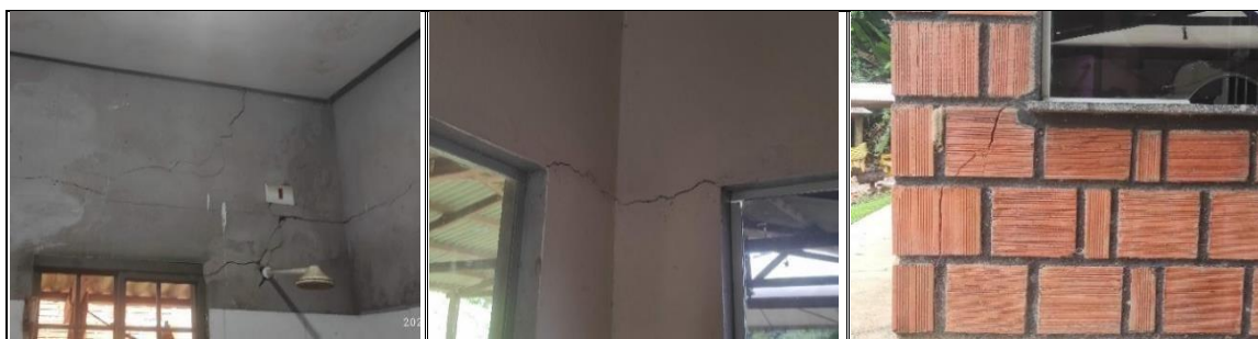
Figura 09: Fissuras, trincas e rachaduras devido a ausência de vergas e contravergas Fonte: Autor
