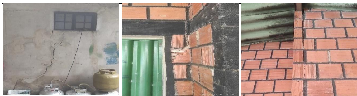
Figura 07: Fissuras, trincas e rachaduras devido a recalque Fonte: Autor
