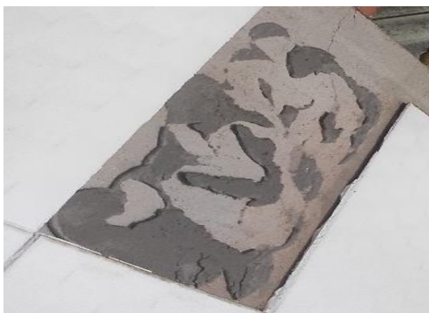
Figura 06: Deslocamento do revestimento cerâmico
