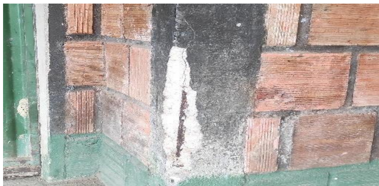
Figura 05: Desagregação do concreto armado Fonte: Autor
