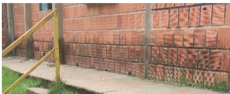
Figura 04: Manchas de umidade
