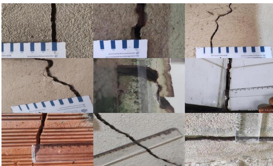
Figura 10: Dimensioamento das fissuras
