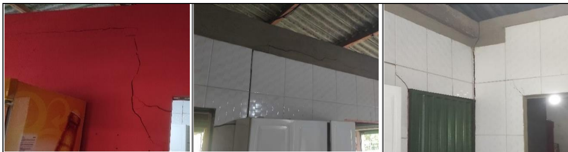
Figura 08: Fissuras, trincas e rachaduras devido a recalque e ausência de vergas Fonte: Autor
