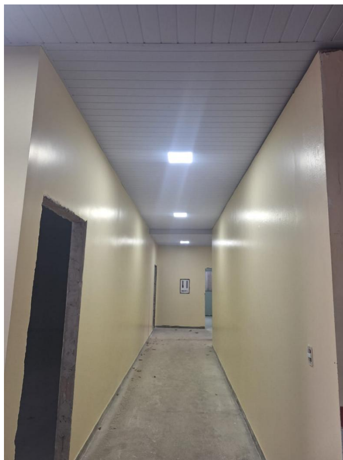
Figura 12 - Obra da Parte 1 do Centro de Inovação Piquiá em Fase de Finalização (vista 2).
