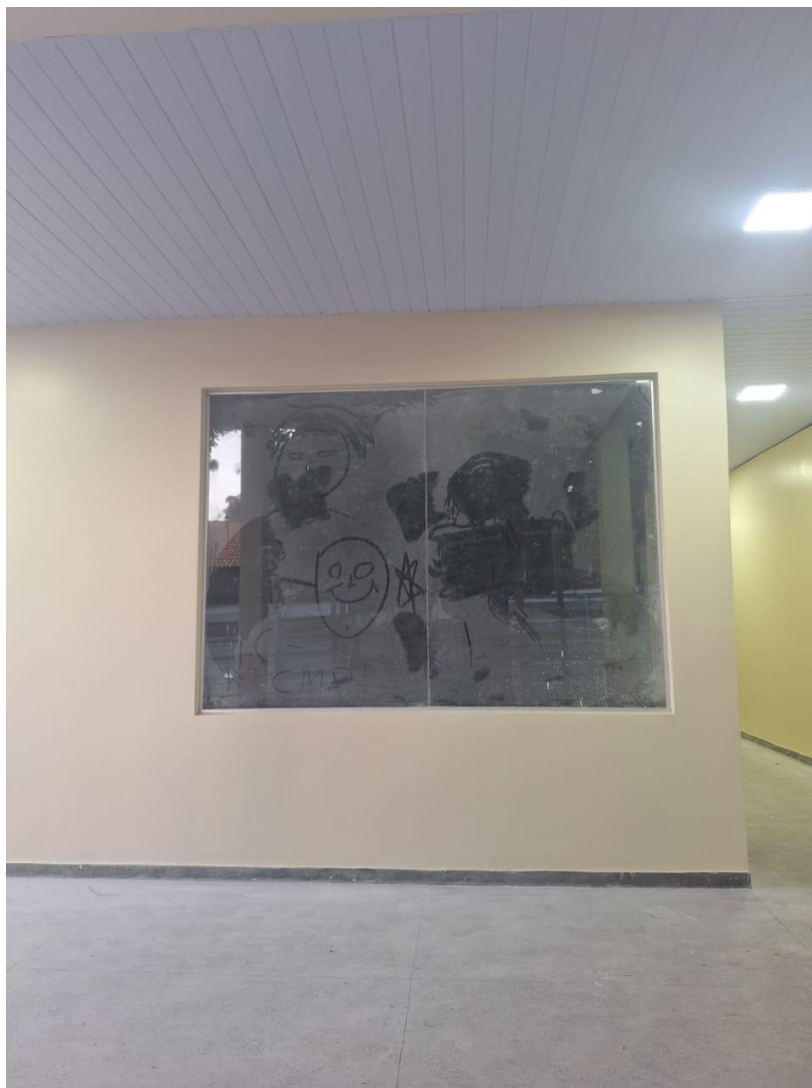
Figura 13 - Obra da Parte 1 do Centro de Inovação Piquiá em Fase de Finalização (vista 3).
