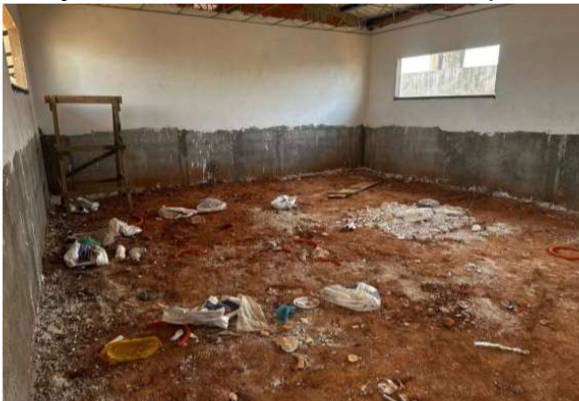
Figura 6 — Ambiente do canteiro de obras com resíduos da construção
