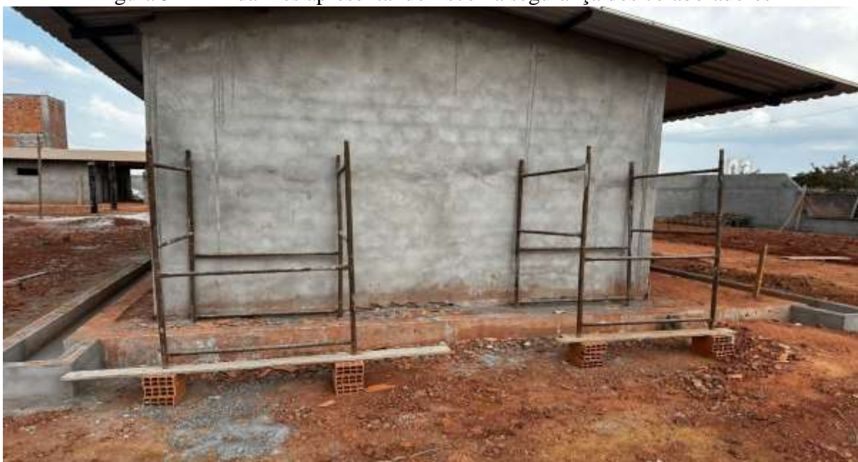
Figura 5 — Andaimos apresentando risco na segurança dos colaboradores
