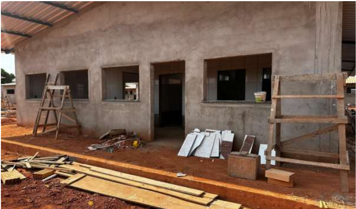
Figura 2 — Resíduos da construção espalhados pelo canteiro
