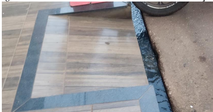
Figura 05- Descontinuidade do rebaixamento da calçada
