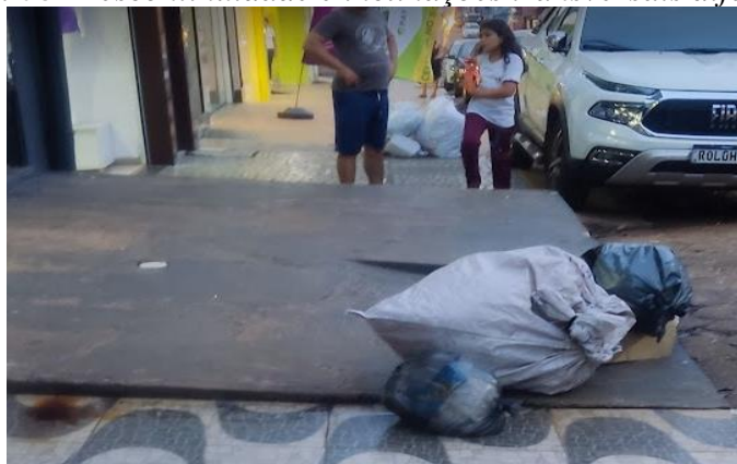
Figura 08- Descontinuidade e inclinações transversais diferentes.
