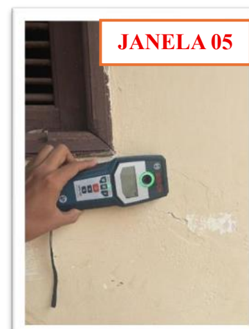
Fotografia 4: Patologia N°04 e sua localização
