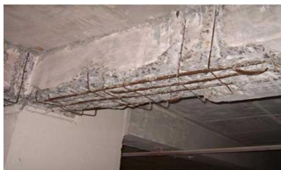
Figura 8 – Corrosão de armadura.
