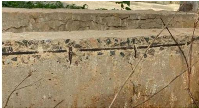
Figura 10 – Deslocamento do cobrimento de concreto causado pela carbonatação.
