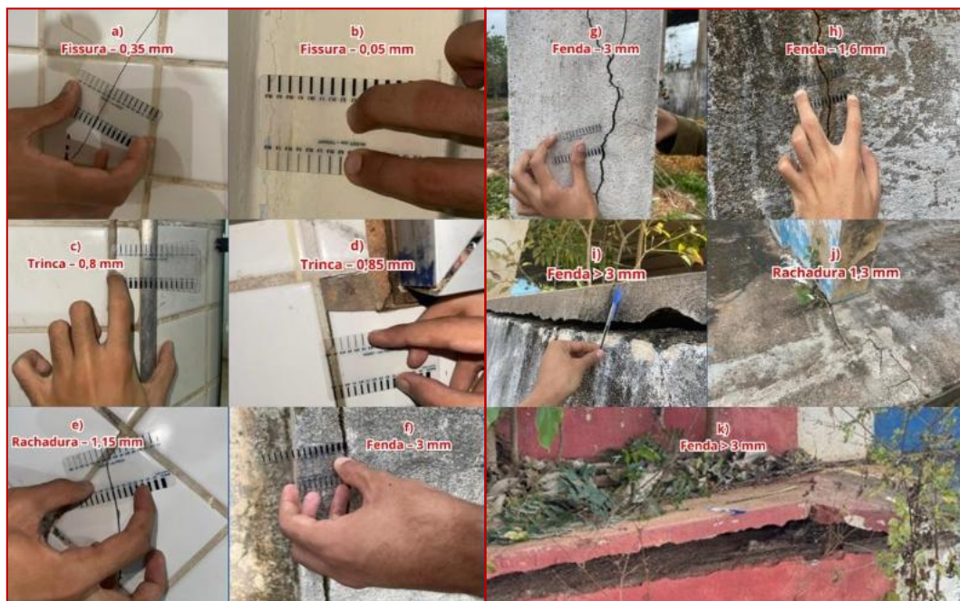
Figura 20 – Manifestações do tipo fissuras observadas no dia 14/10/2025 às 09h31.
