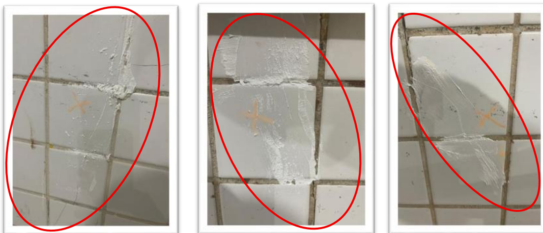
Fotografia : Patologia N°02 e sua localização aproximada
