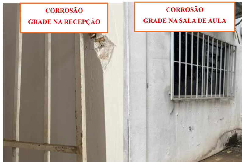
Figura 44 – Corrosões superficiais identificadas em grades da recepção e janela da sala de aula, registradas em 19/01/2026 às 10h10.
