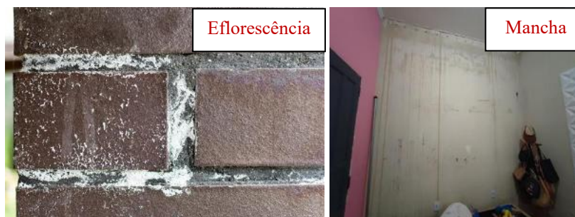
Figura 6 – Esquerda: Eflorescência em estrutura. Direita: Mancha provocada por umidade.
