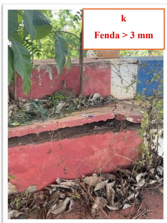
Fotografia 2: Patologia Nº02 e sua localização
