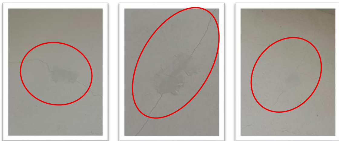
Fotografia 4 : Anomalia Nº02 e sua localização aproximada
