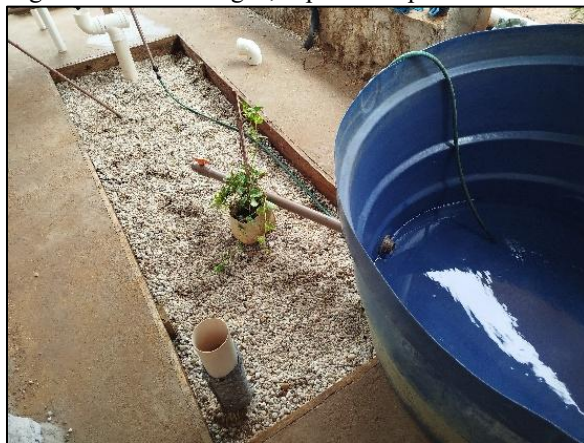
Figura 29: caixa de água, capacidade para 1000 litros.
