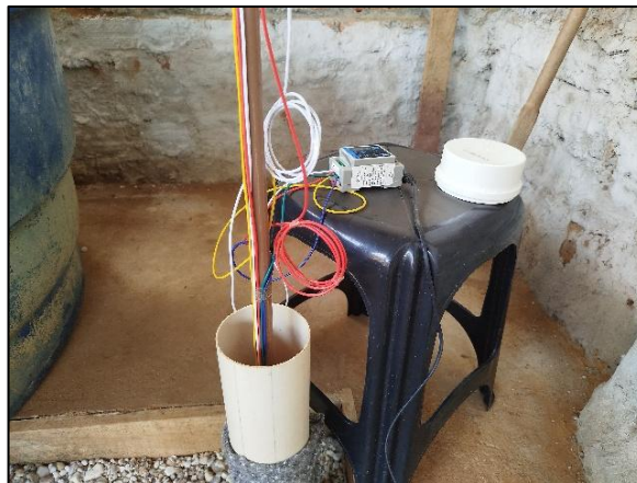
Figura 39: dispositivo piezométrico finalizado.
