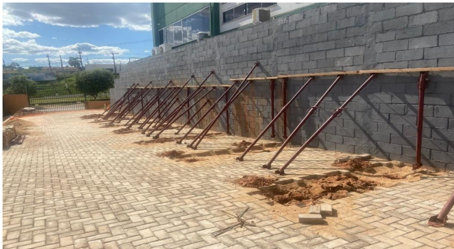
Figura 4: A imagem mostra o muro que está sendo escorado com escoras metálicas inclinadas, indicando risco de instabilidade.
