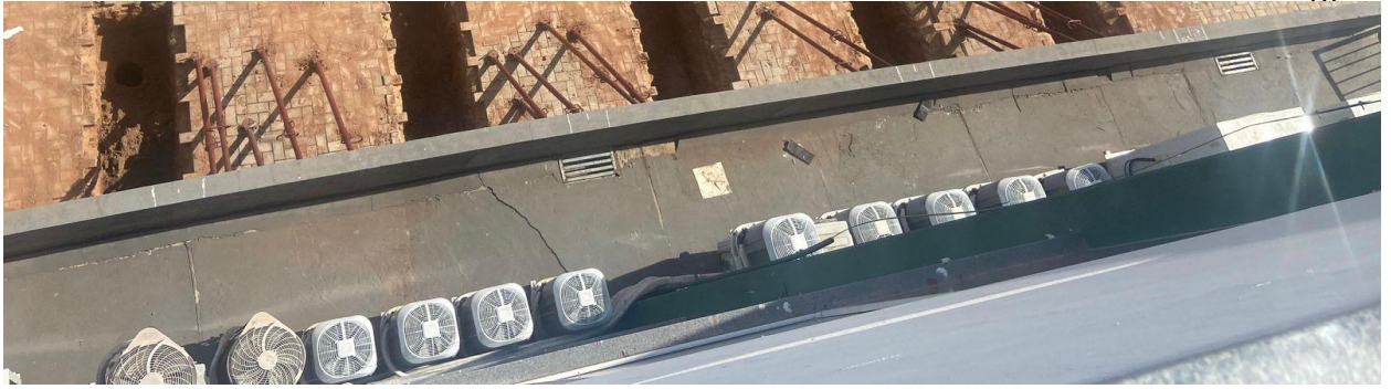
Figura 1: Mostra o deslocamento do muro em relação ao piso, evidenciado por rachaduras no piso causadas por movimentações estruturais.
