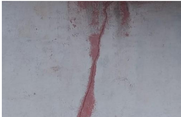
Figura 1 – Fissura em parede
