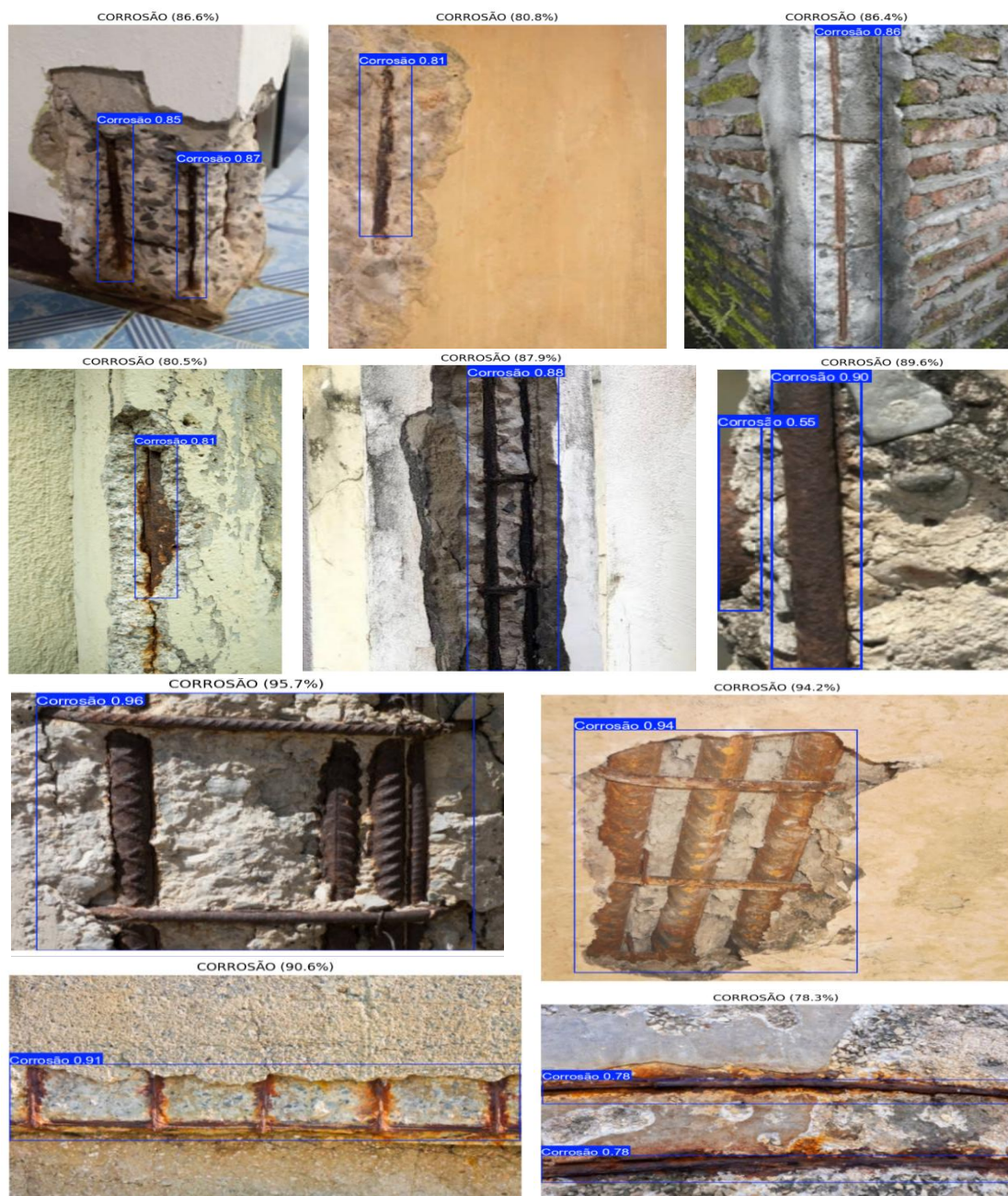
Figura 27 – Resultado de detecção para corrosão
