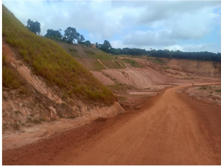
Figura 15: Voçoroca do bairro Terra Bela
