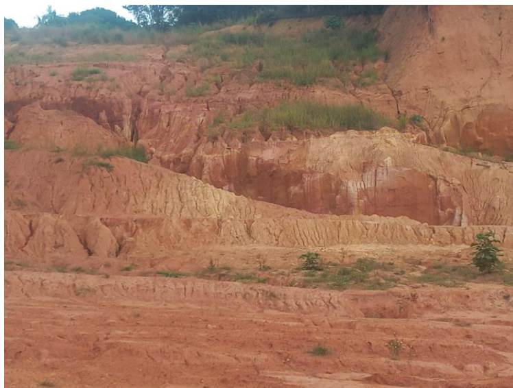
Figura 9: Talude que sofreu processo erosivo após intensas chuvas
