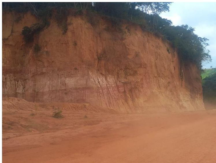
Figura 8: Talude da Voçoroca
