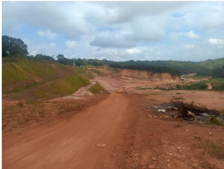
Figura 7: Voçoroca do bairro Terra bela
