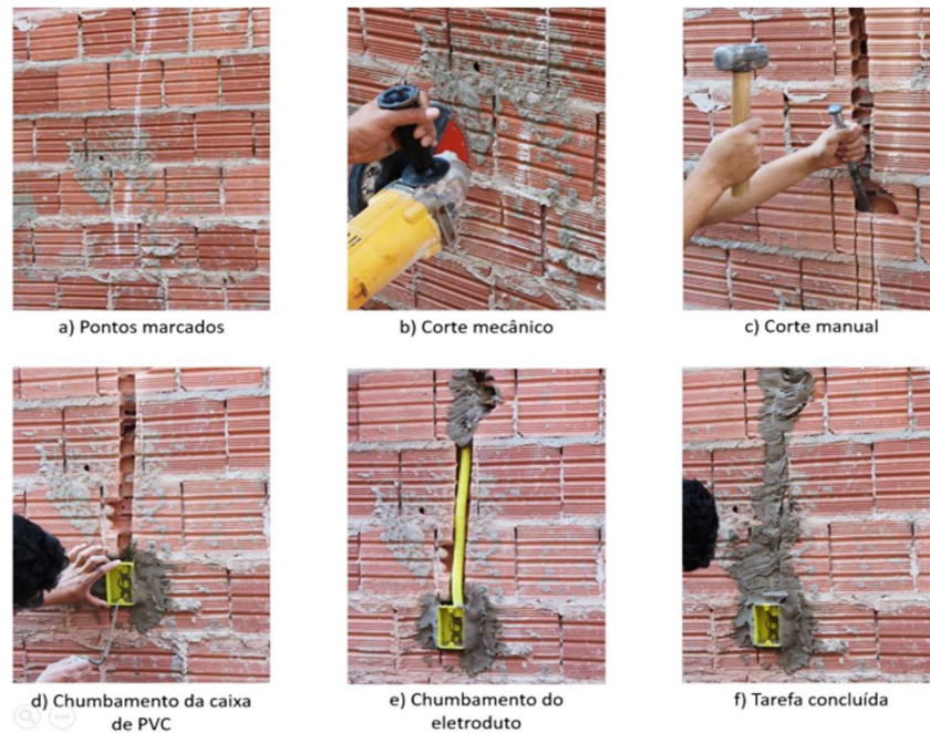
Figura 15 – Esquema de colocação de caixa de PVC e eletroduto em parede de alvenaria
