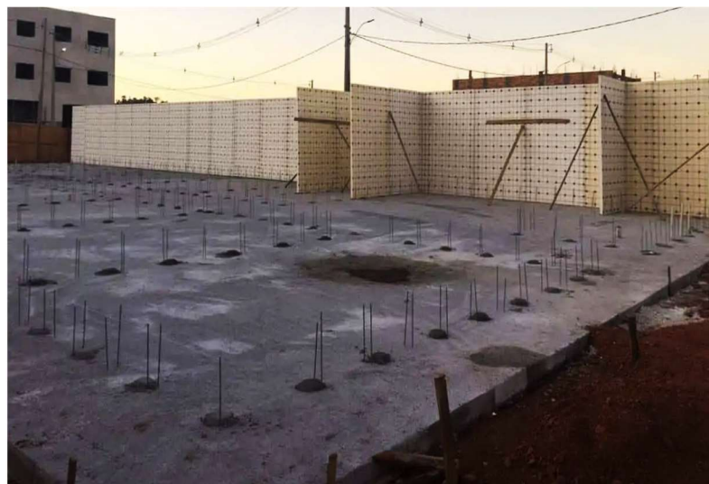
Figura 21 – Barras de aço fixadas na fundação para receber os painéis de EPS.
